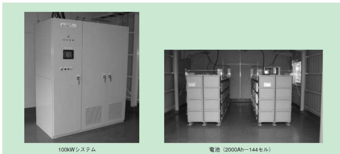
図15 電力貯蔵システム1号機 (100kW) Fig.15 Power Storage System for Demonstration Test.
